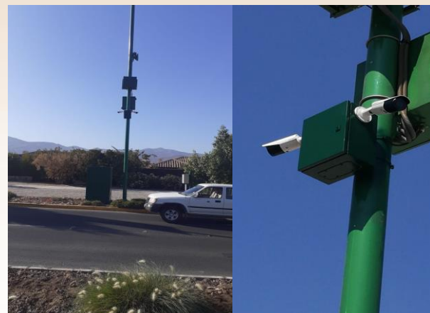
Instalación 1 domo condominio Los Montes
